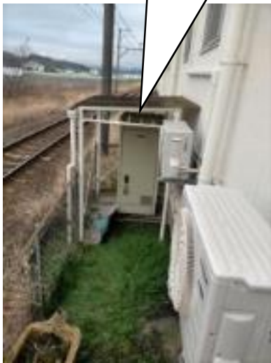
旧 給湯器(電気)
